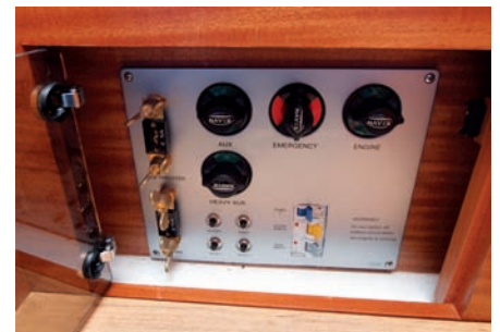
Professionell: Die Installationen sind solide ausgeführt.
